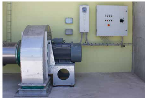
Quadro elettrico per acquisizione segnali di campo ed inverter Elektrischer Schaltschrank für Feld- und Invertersignale
