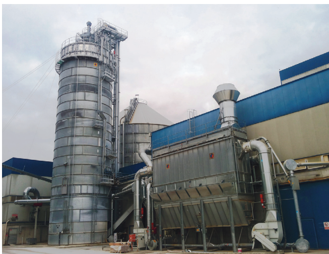
Silo di stoccaggio e filtro a maniche con pannelli antiscoppio REMBE®
