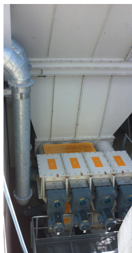
Coclee poste sotto la tramoggia di ricevimento materiale
